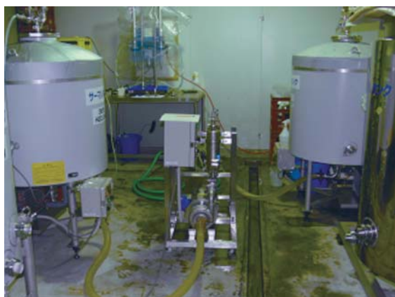
図3 耐圧タンク間ろ過作業の様子 10ミクロンと0.45ミクロンのカートリッジフィルターを連結したろ過装置（中央）を使用
