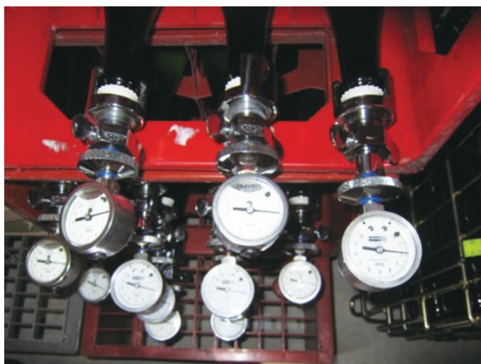
図 6 ガス圧の管理 (水平の状態を上から撮影)
